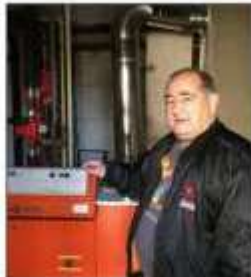
Le 1 er adjoint Michel Lederman aux côtés de la chaudière de la cantine, qui sera bientôt remplacée. Photo LBP/S. T.
