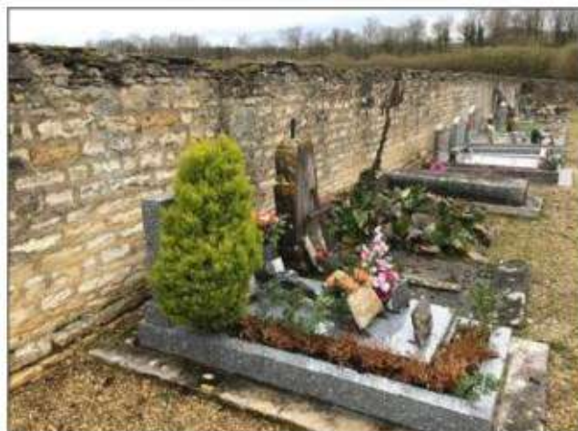
Les élus débattront d'une convention avec le conseil départemental pour la restauration du mur du cimetière. Photo LBP/S. T.
