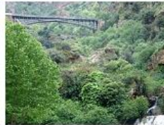
Le pont de chemin de fer aux « Cascades d'el Ourit » à Tlemcen
